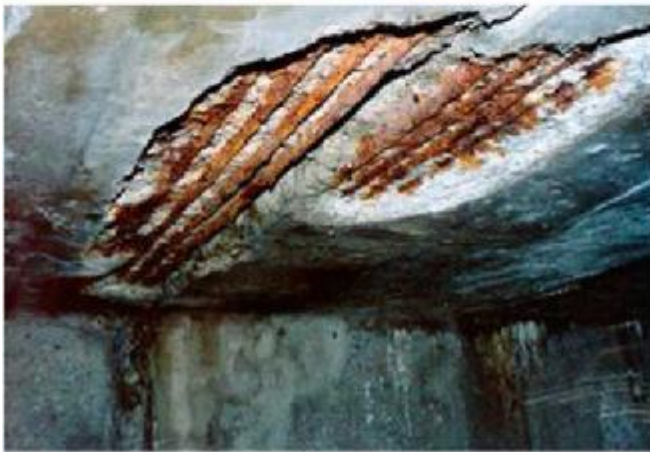
1973-ban épített IPANEX® földém (felső kép), 1974-ben épített kontroll földém (alsó kép) - Pennsylvania Turnpike, mindkét fotó 1998-ban készült.
